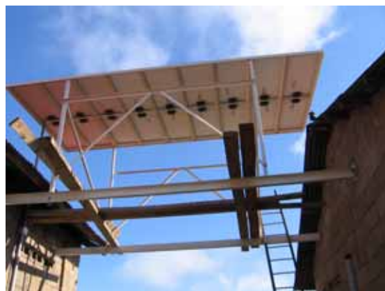
Il nuovo impianto fotovoltaico per la pompa solare
