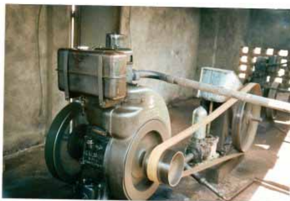
Vecchia pompa meccanica a stantuffo, collegata ad un motore diesel "lister" del 1986.
