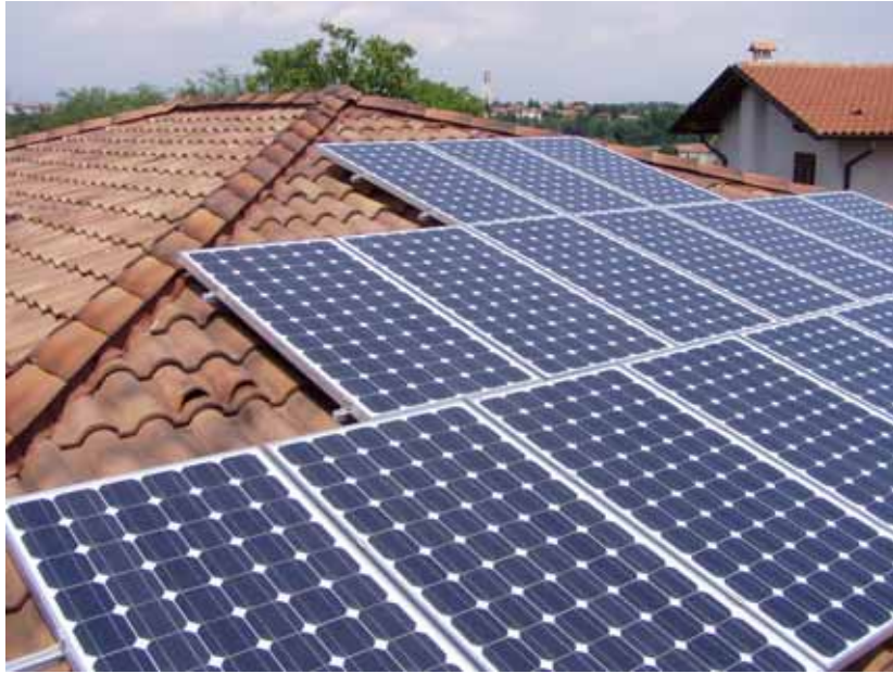
Impianto da 3,7 kWp realizzato a Trezzo sull'Adda (MI) – 07/2005
