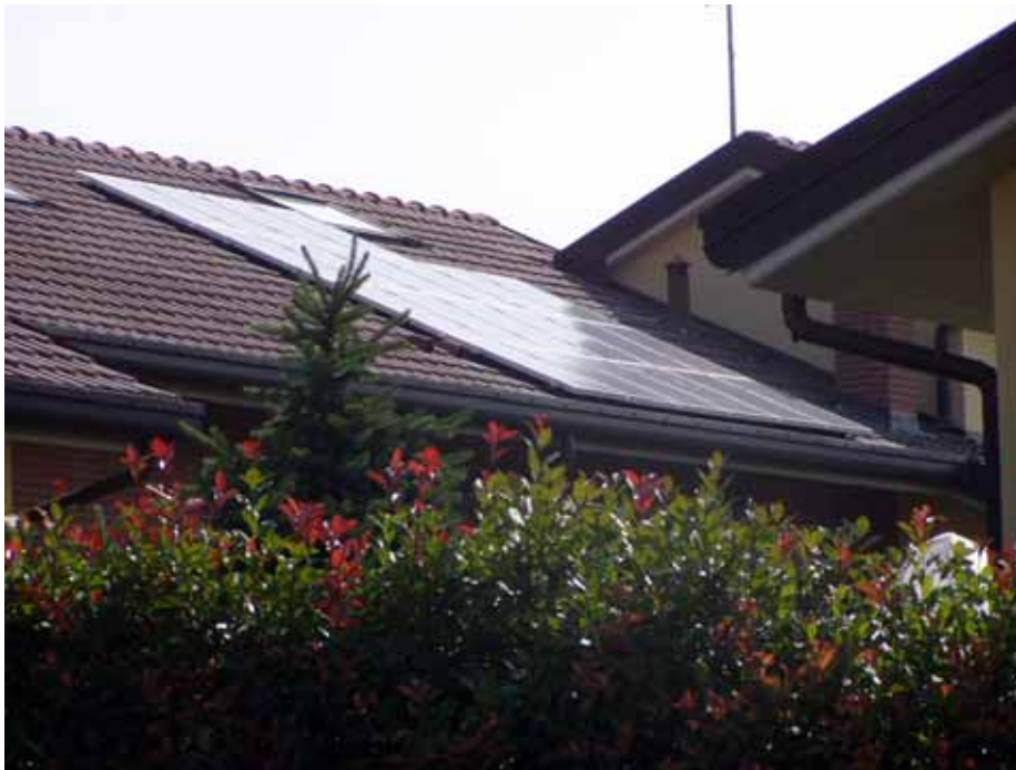
Impianto fotovoltaico da 4,5kWp realizzato a Bellusco (MI) – 07/2005
