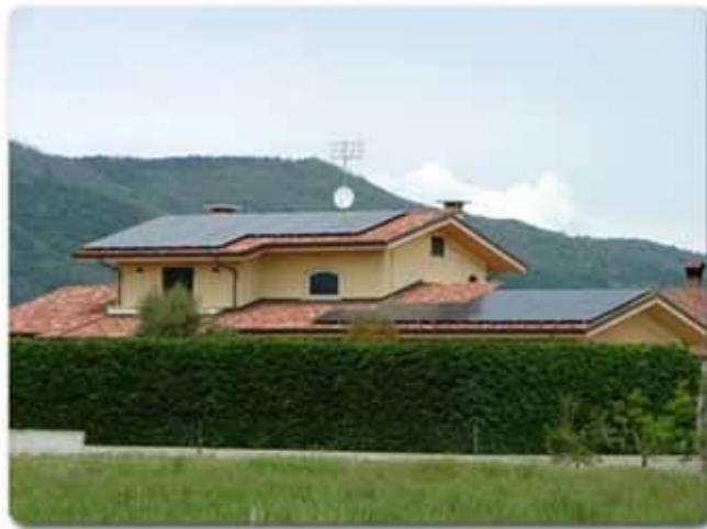
Impianti su edifici
