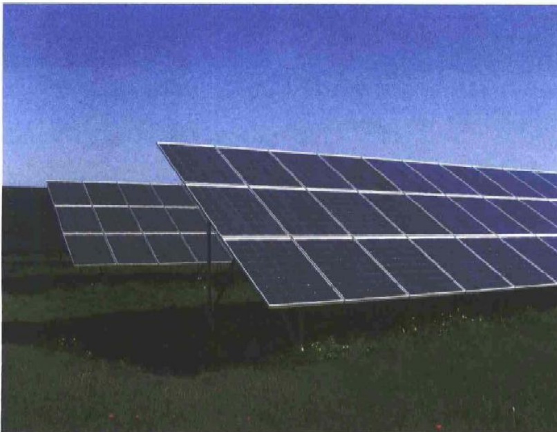
Parco Solare di Grottaglie (TA) realizzato dalla società Enerpoint S.r.l.
