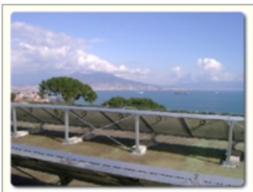
impianto realizzato a Napoli
